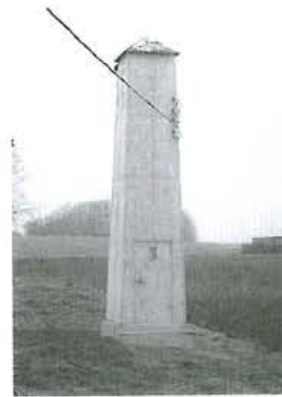
Den meget enkle og elegante transformatorbygning passer fint i landskabet. El-ledningerne tegner landskabets form.
