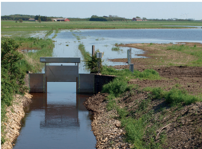
Sluse med højvandslukke ved udløbet fra Grynderup Sø
