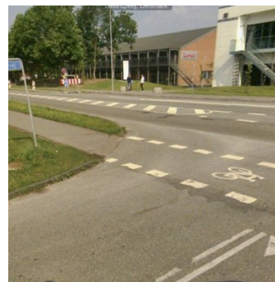
Billede 111: Manglende overgang for fodgængere på Egerisvej ved sidevej.
