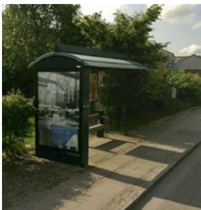
Billede 65: Busstop på Østerrisvej mangler korrekt belægning, opmærksomheds- og retningsfelt.
