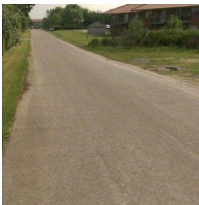
Billede 118: Manglende fortov på Kastanievænget.
