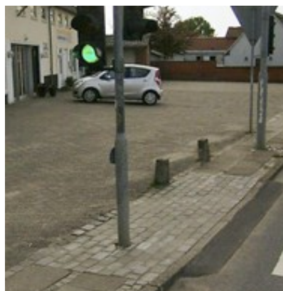
Billede 36: Signalstander i gangbane på Søndergade, og manglende tilgængelighedsløsning.
