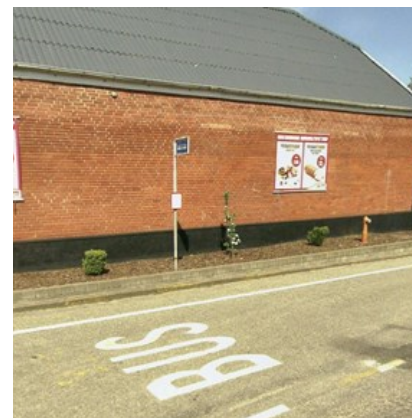
Billede 82: Gangbane ved busstop på Borgergade mangler læskærm, bæk og korrekt belægning.
