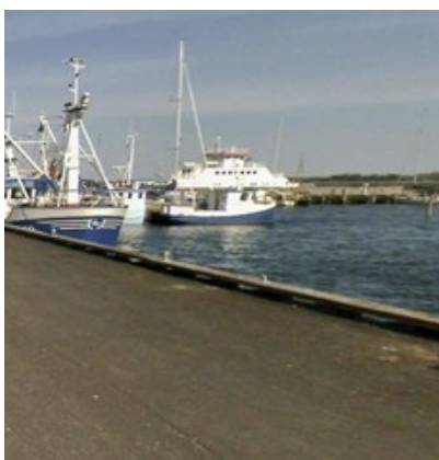
Billede 53: Manglende rækværk og kontrastfarve på kajen.
