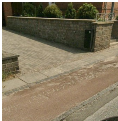
Billede 113: For smal gangbane på den ene side af Brårupvej samt ujævn belægning.
