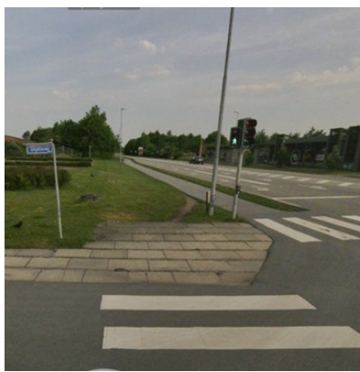
Billede 122: Retningsfelt og opmærksomhedsfelt mangler ved lyskryds på Skyttevej.
