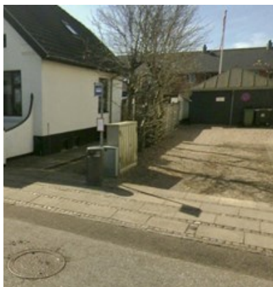
Billede 60: Busstop på Durupvej placeret ud for indkørsel. Der mangler læskærm, bæk, korrekt belægning og opspring mod kørebane.
