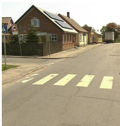
Billede 81: Reguleret overgang på Østergade mangler korrekt belægning.
