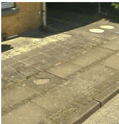
Billede 44: Ujævn belægning pga. slid på Toustrupvej.
