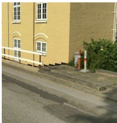
Billede 63: Trappe på Søbyvej mangler opmærksomhedsfelt og trinmarkering.
