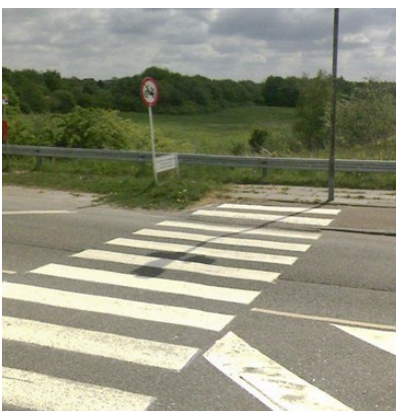
Billede 94: Reguleret overgang på Resenvej mangler taktile elementer og opspring for synshandicappede.
