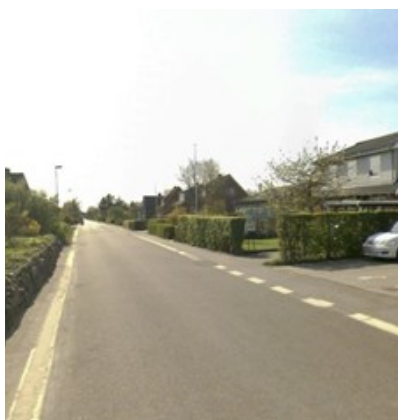
Billede 54: Manglende gangbane på Sønderhedevej, kun afstrikning med kantbaner.
