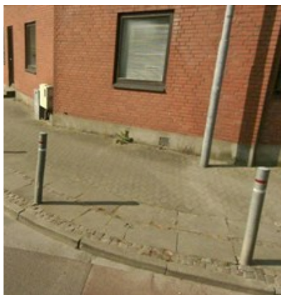
Billede 66: Pullerter i gangbane på Viborgvej ikke markeret.
