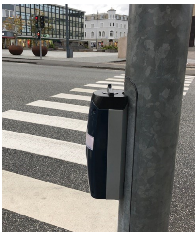
Billede 126: Reguleret overgang, hvor retningspilen peger i en forkert retning.
